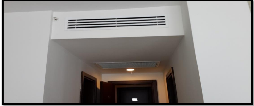
Şekil: 3.132. Baia Hotel, Junior Suit Oda, Fan-coil Havalandırma Sistemi
