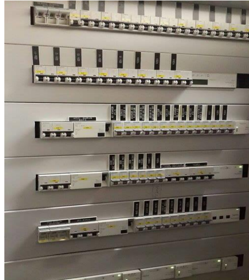
Şekil: 4.52. Renaissance İstanbul Polat Bosphorus Hotel, Katta Bulunan Elektrik Sistemleri
