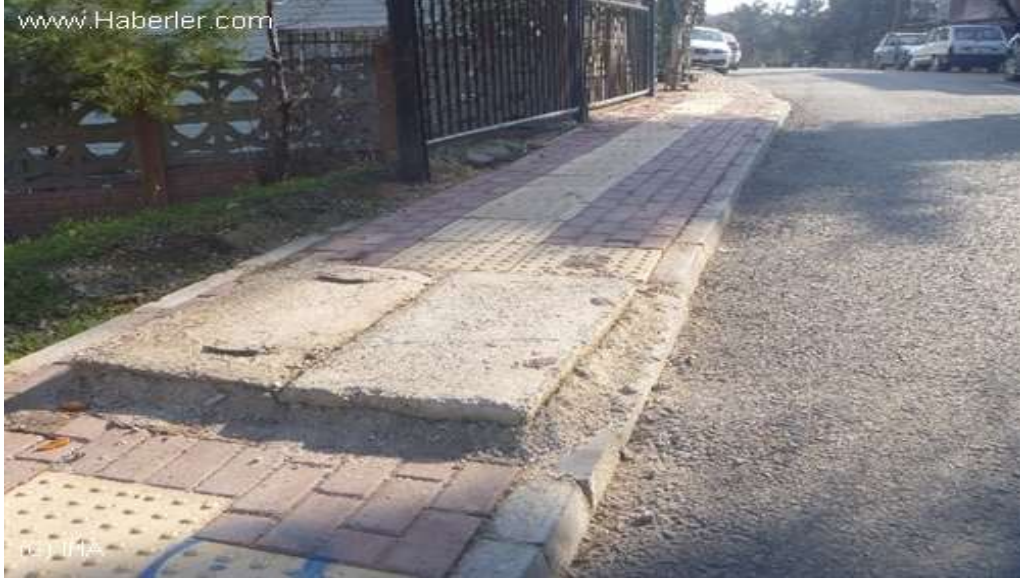
Şekil 2.19. Bilecik'te yapılmış olan hatalı bir hissedilebilir yüzeyli kaldırım çalışması.
