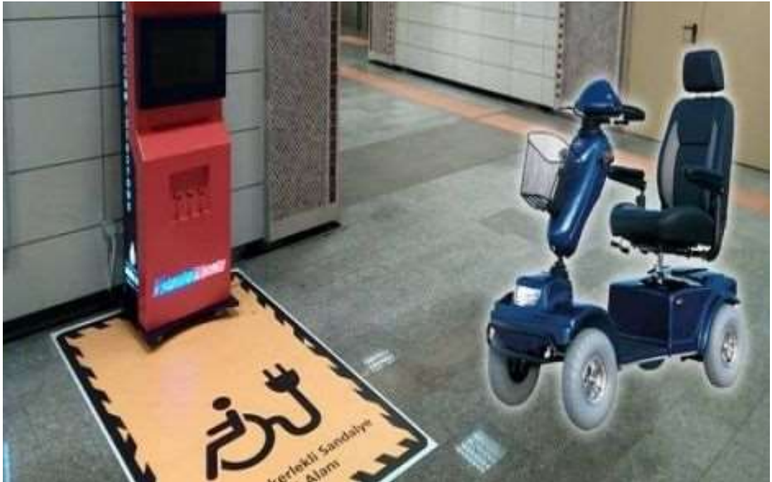
Şekil 2.16. İstanbul Büyükşehir Belediyesi'nin Metro İstasyonu'nda uygulamış olduğu engelli araçları için şarj ünitesi çalışması.
