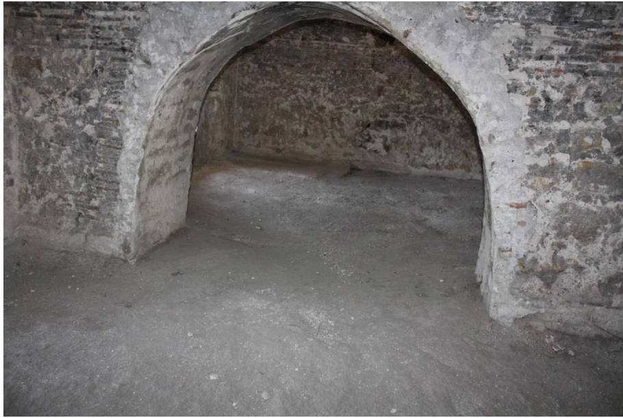
Resim 12: Sivas Behram Paşa Hanı Oda Örneği İki Oda Birleştirilerek Tek Oda Yapılmıştır.
