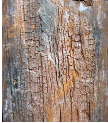
Resim 4.3: Ahşabın çürümmesine örnek
