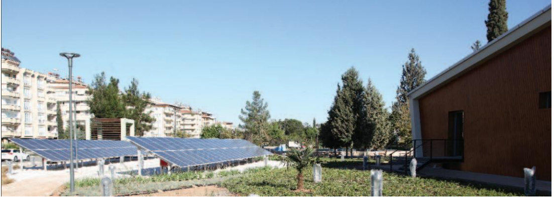
Şekil 4.10. Gaziantep Yeşil Ev, Güneş Enerjisi Sistemi (URL-34)
