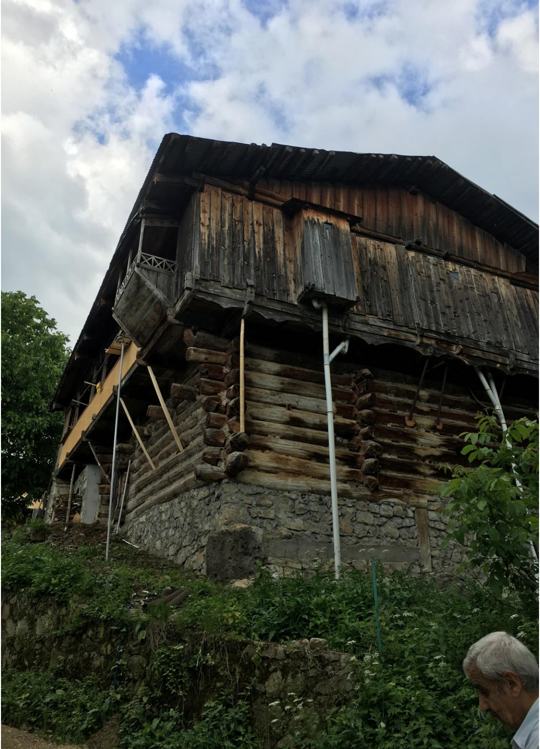
Şekil 5. 8. Doğu Karadeniz Evinde Niteliksiz Tesisat Eklentileri / Artvin – Şavşat (Balvana)
