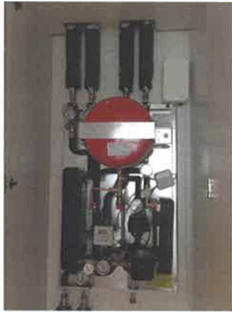
Şekil 4.23. Torun Center Substation
