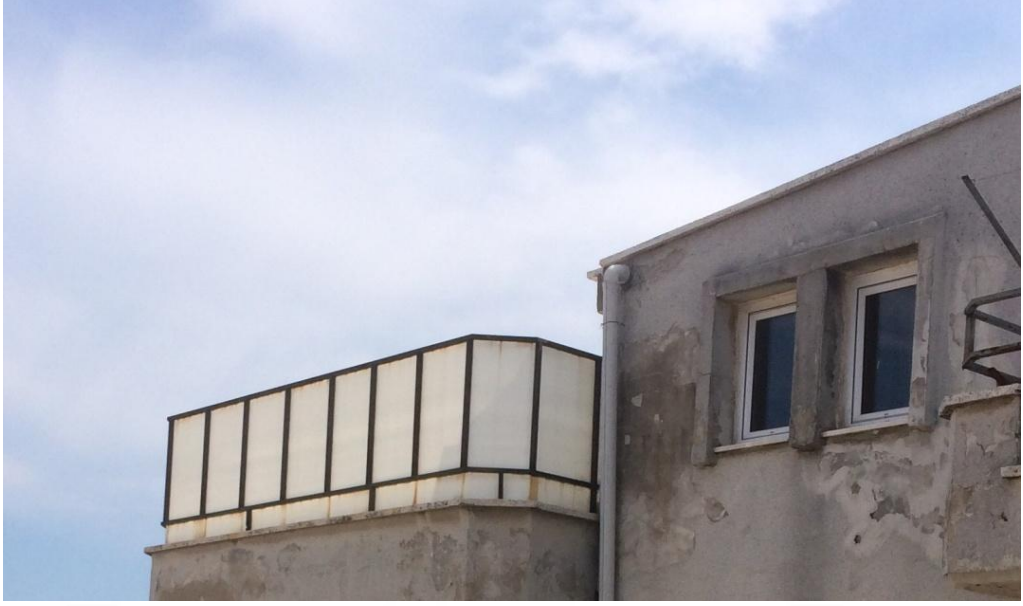
Şekil 3.3. Suyun Parapette Meydana Getirdiği Tahribat
