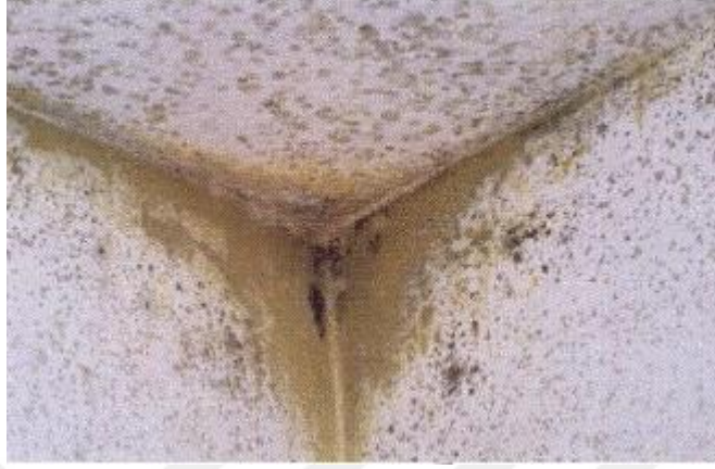
Şekil 2.19. Bina İçinde Meydana Gelen Yoğuşma
