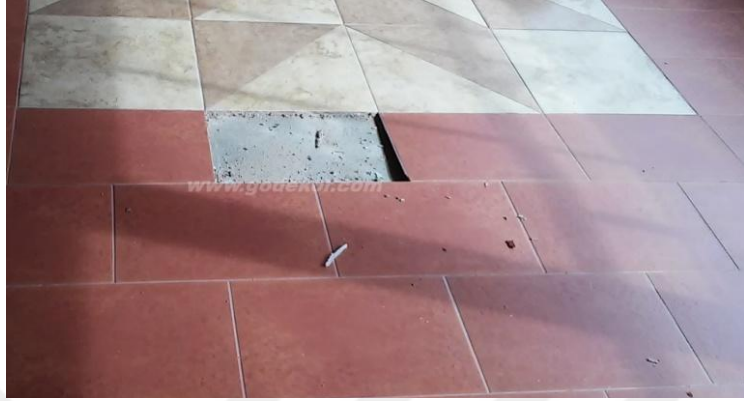
Şekil 3.8. Isı Genleşmesi Sonucu Bir Döşeme Kaplamasında Görülen Kabarma
