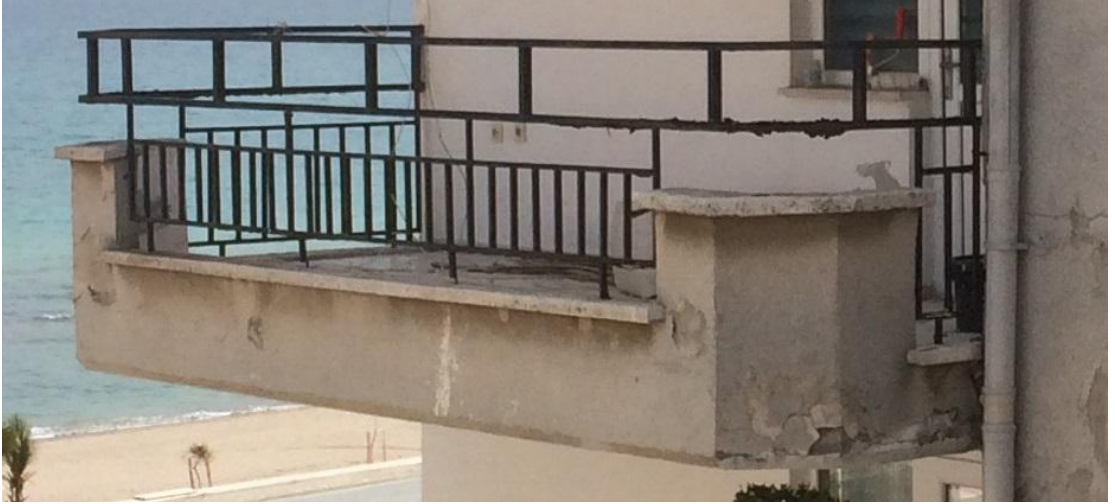
Şekil 3.4. Suya Maruz Kalan Demir Korkulukta Korozyon Tahribatı
