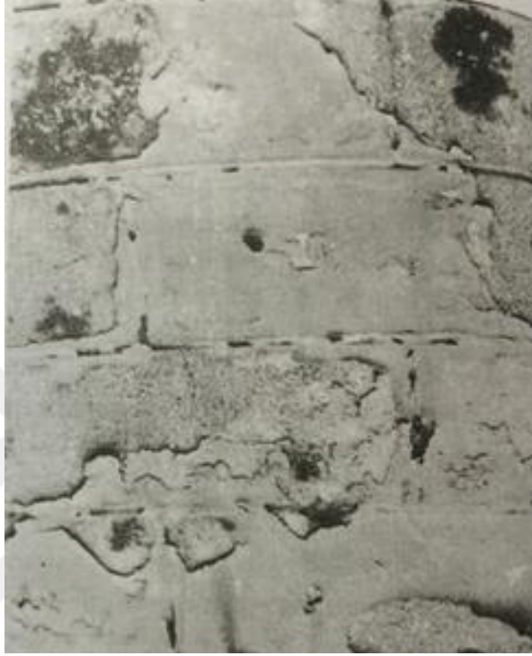
Şekil 3.6. Kondansasyon Sonucu Tahrip Olan Boyalı Bir İç Yüzey
