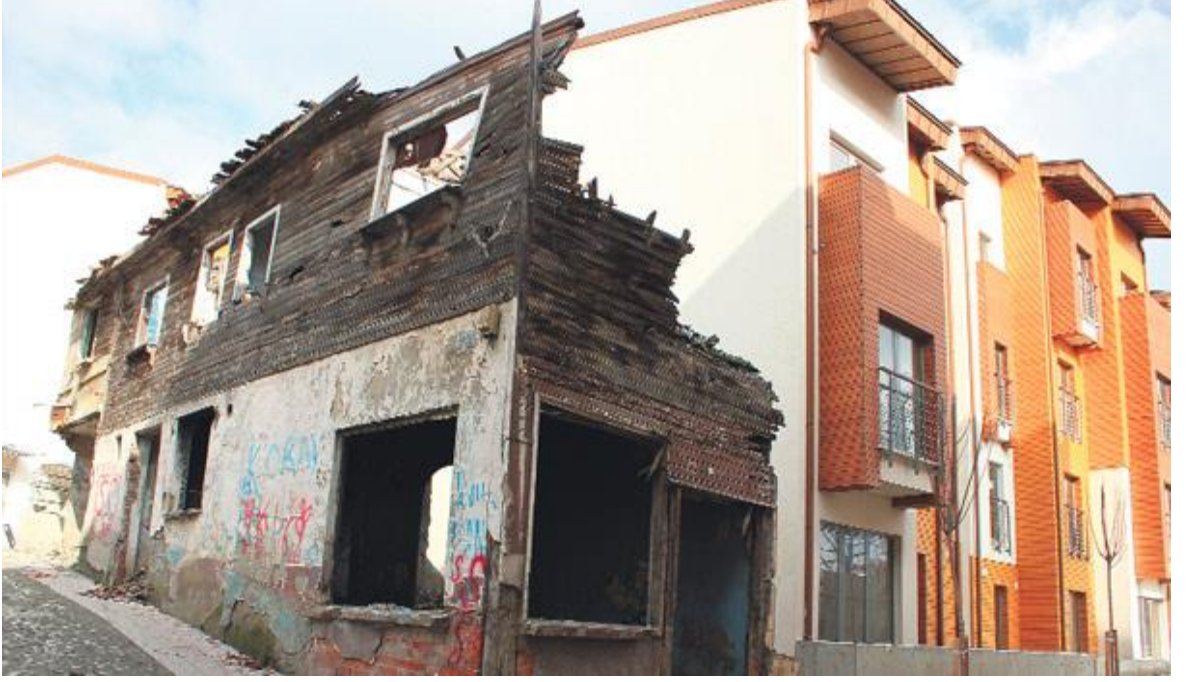
Şekil 4.17. Sulukule Kentsel Dönüşümü Sonrası Yıkılmayan Tarihi Eser Niteliğindeki Binalar
