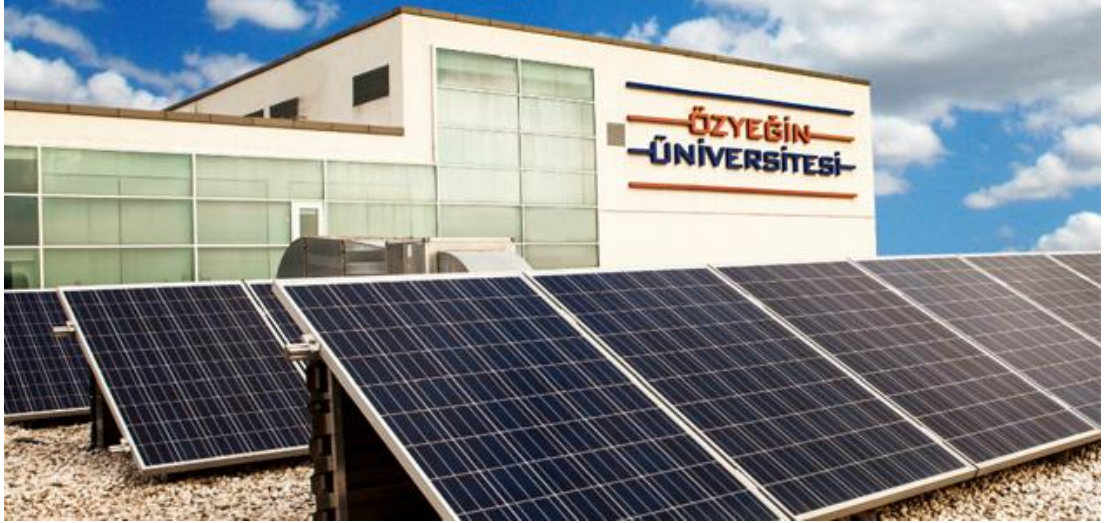
Şekil 5.16. Çatılarda Konumlandırılan Sıcak Su ve Elektrik Üretilen Güneş Enerjisi Panelleri
