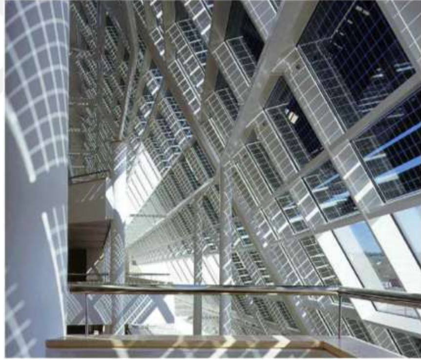
Şekil 2.4. Doxford International Park İçinde Yer Alan Solar Office Binasında Fotovoltaik Pil Kullanımı (Url-2).
