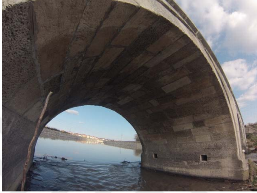
Şekil B.51: Büyükkarıştıran Köprüsü hasar tespit fotoğrafı - 1
