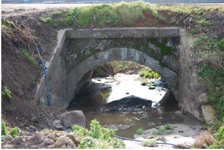
Şekil B.54: Büyükkarıştıran Köprüsü hasar tespit fotoğrafı – 4
