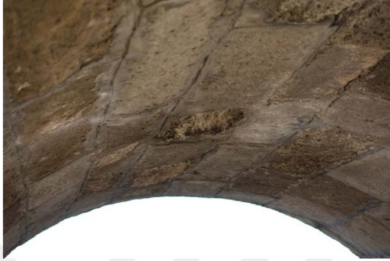
Şekil B.55: Büyükkarıştıran Köprüsü hasar tespit fotoğrafı – 5
