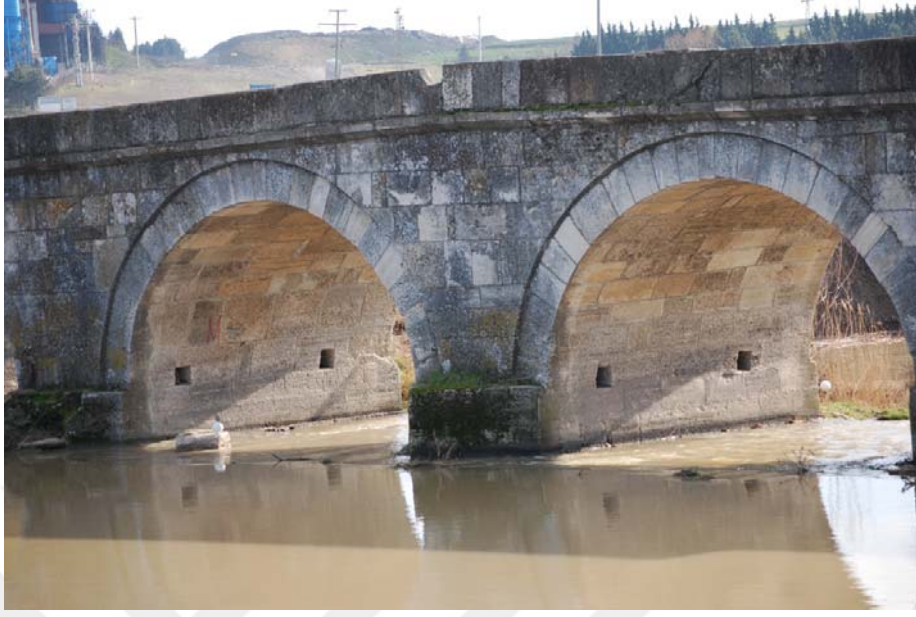
Şekil B.53: Büyükkarıştıran Köprüsü hasar tespit fotoğrafı – 3
