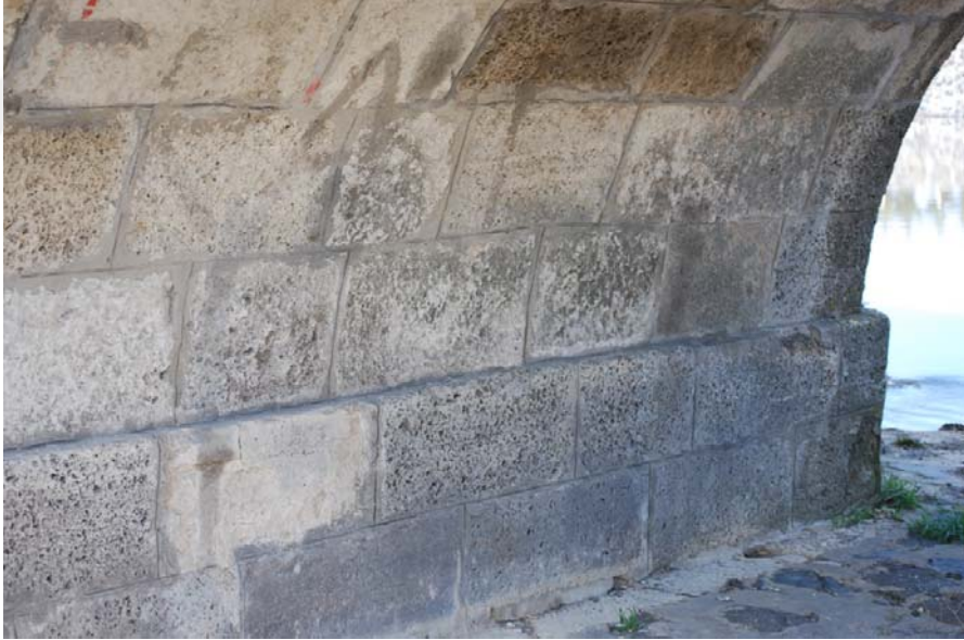
Şekil B.56: Büyükkarıştıran Köprüsü hasar tespit fotoğrafı – 6
