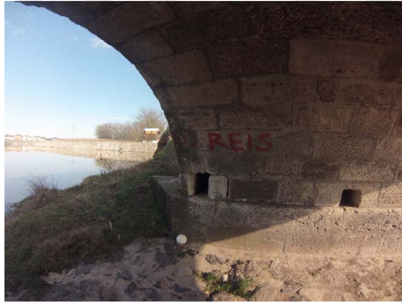
Şekil B.52: Büyükkarıştıran Köprüsü hasar tespit fotoğrafı - 2
