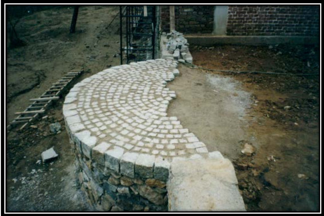
Şekil 3.87. Restorasyon Öncesi Park Zemin Taşlarının Durumu
