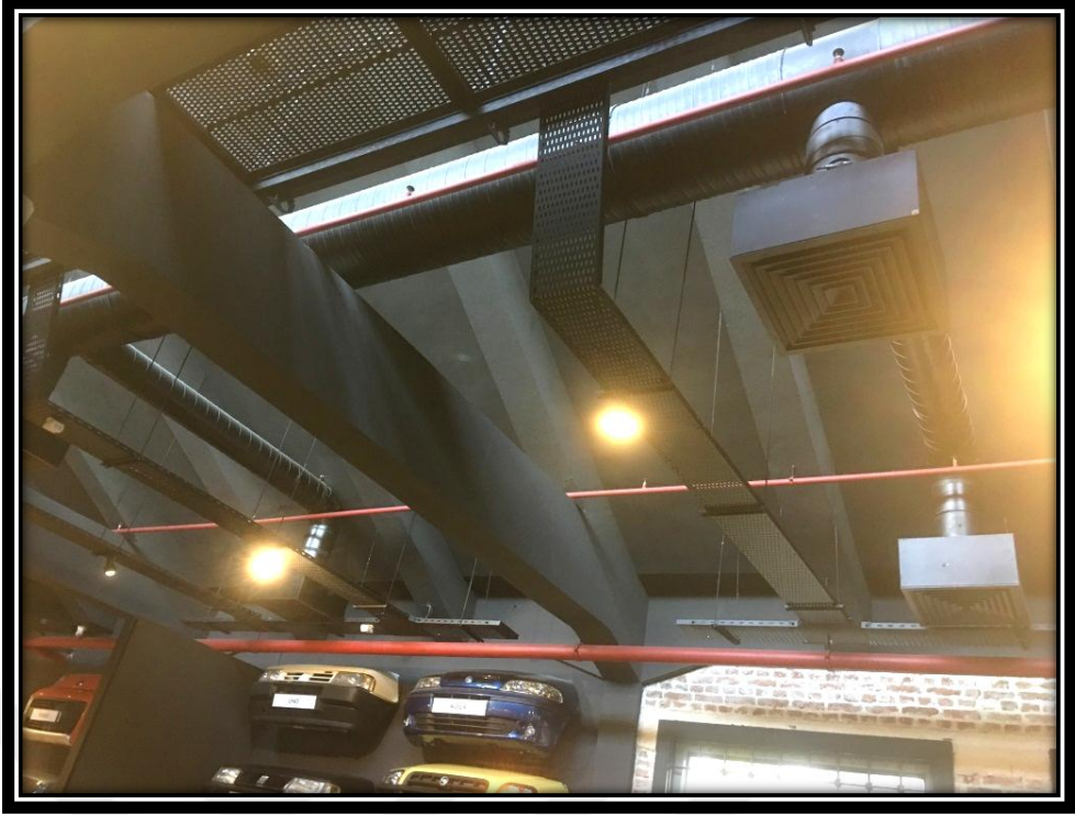
Şekil 3.43. Restorasyon Sonrası Tavandan Geçen Havalandırma Kanallarından Görünüş-1
