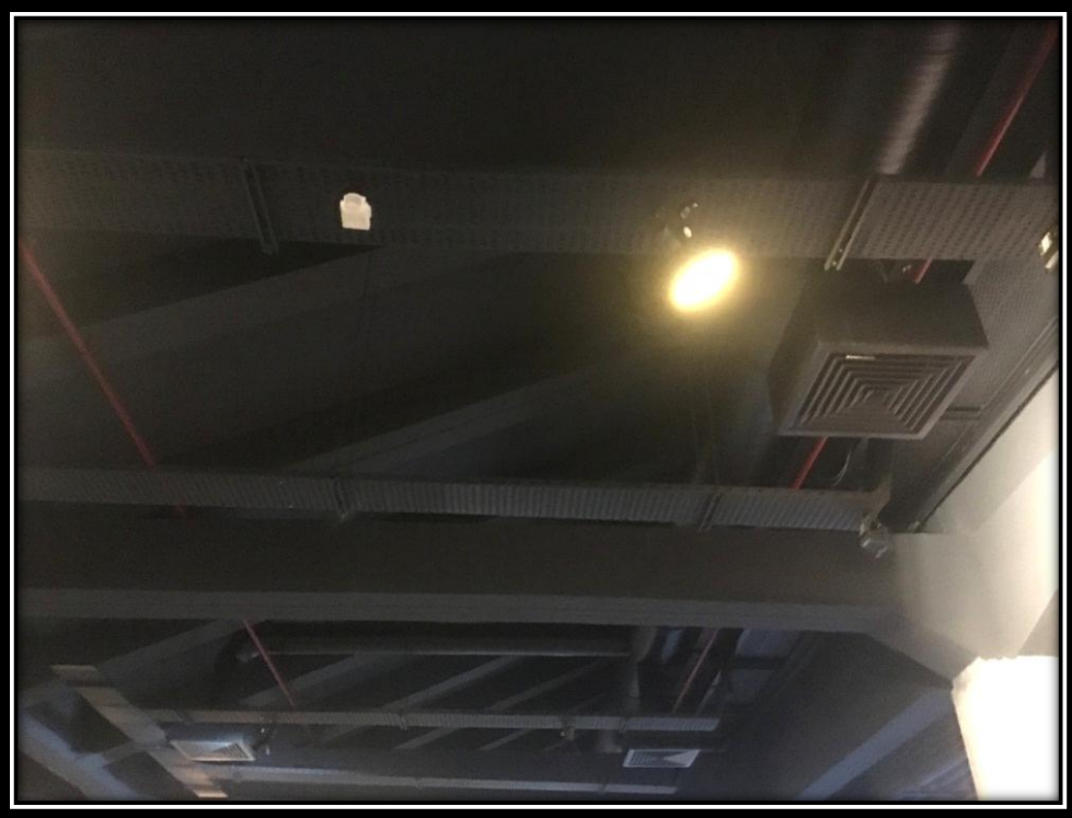
Şekil 3.44. Restorasyon Sonrası Tavandan Geçen Havalandırma Kanallarından Görünüş-2
