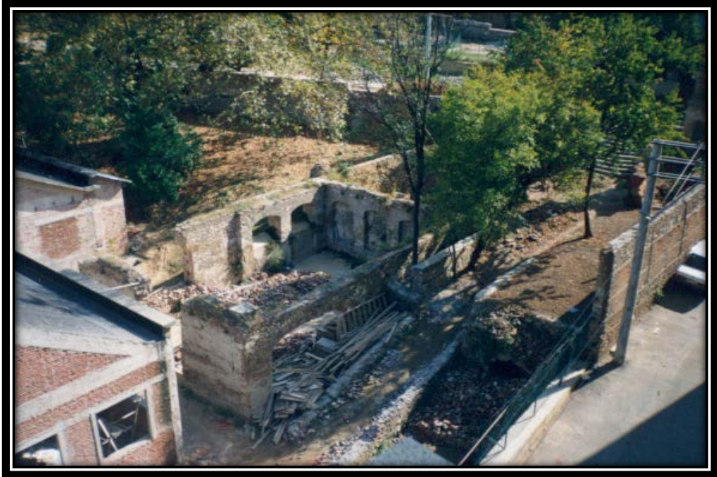
Şekil 3.30. Yıkılan Mancınıkhane Binasına Tepeden Bakış
