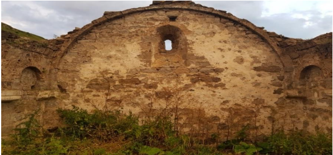
Şekil 3.60. Kızlar Manastırı'nın Tavan Kısmı Günümüzde Büyük Ölçüde Çökmüş, Cephelerdeki İşlemeler Tahrip Edilmiş Durumdadır
