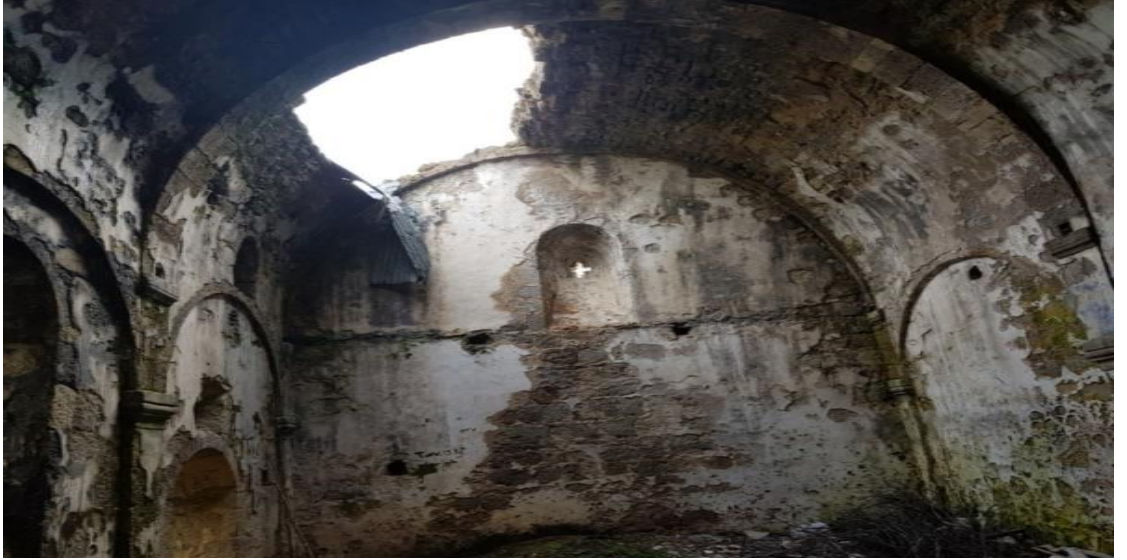
Şekil 3. 52. Meryem Ana II Kilisesi'nin İçten Görünüşü. Kilisenin Çatı Kısımında Göçmeler Dikkati Çekmektedir
