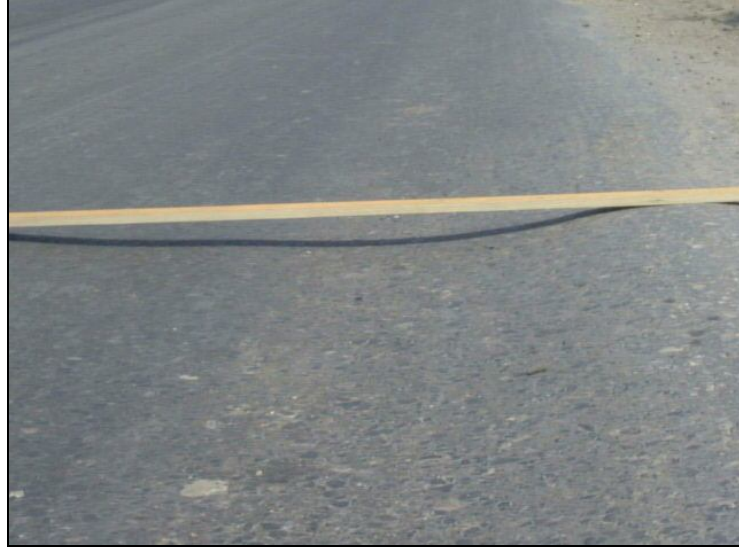
Şekil 2.13. Tekerlek izinde oturma örneği[19].
