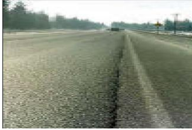
Şekil 1.7. Kenar Çatlakları (Avcı,2009).
