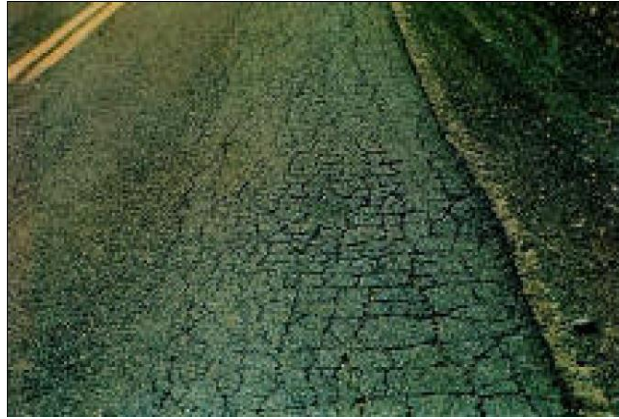
Şekil 1.5. Timsah Sırtı Çatlak (Avcı,2009).
