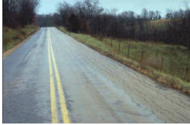
Şekil 1.6. Yorulma Çatlağı (Avcı,2009).
