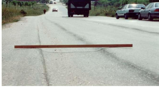
Şekil 1.4. Tekerlek izinde yapısal oturma örneği
