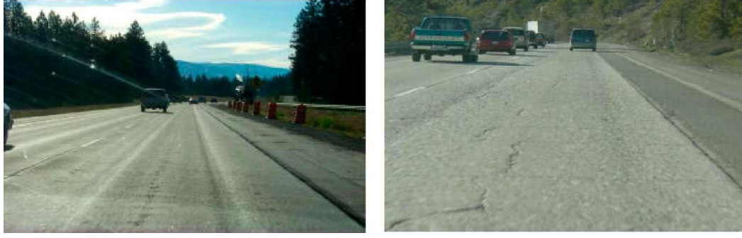
Şekil 1.9. Çivili lastiklerin yol üzerindeki hasarları
