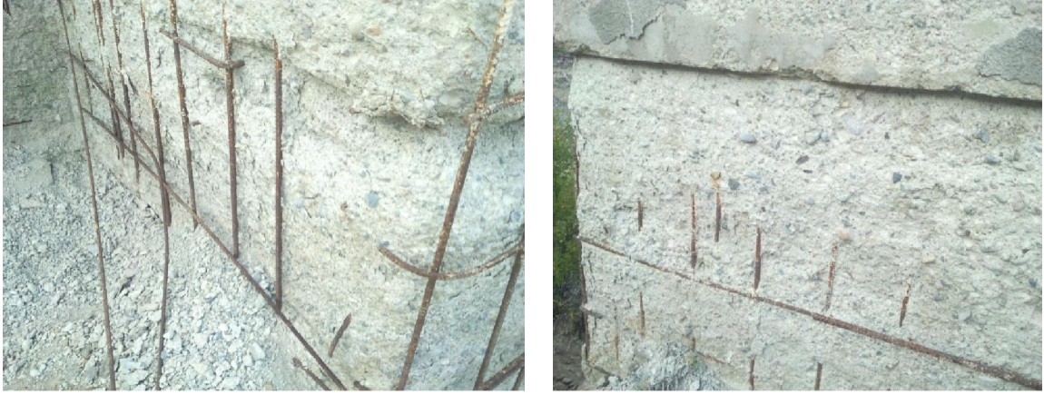
Şekil 1.6 Donma-çözülme etkisi ile bozulmuş beton elamanları
