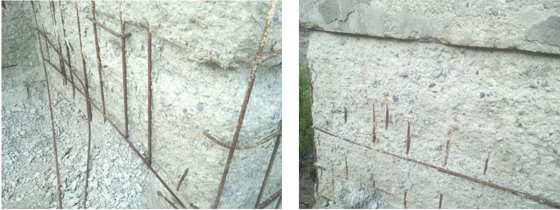
Şekil 1.5. Donma-çözülmenin betonarme elamanlar üzerinde etkisi
