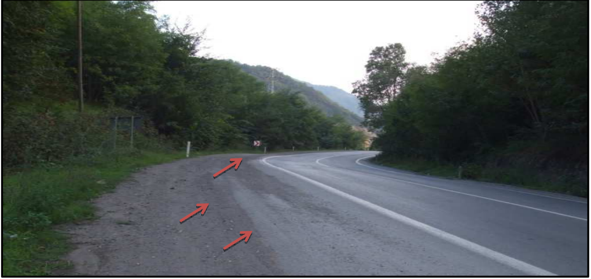
Şekil 4.11. Mevcut yol platformunda gözlenen deformasyonlar
