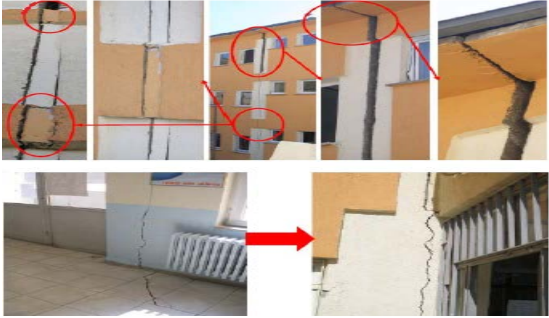
Şekil 5.3. İmam Hatip Lisesi duvarlarındaki hasarlar (Karslı; Alemdağ; Dağ, 2011).
