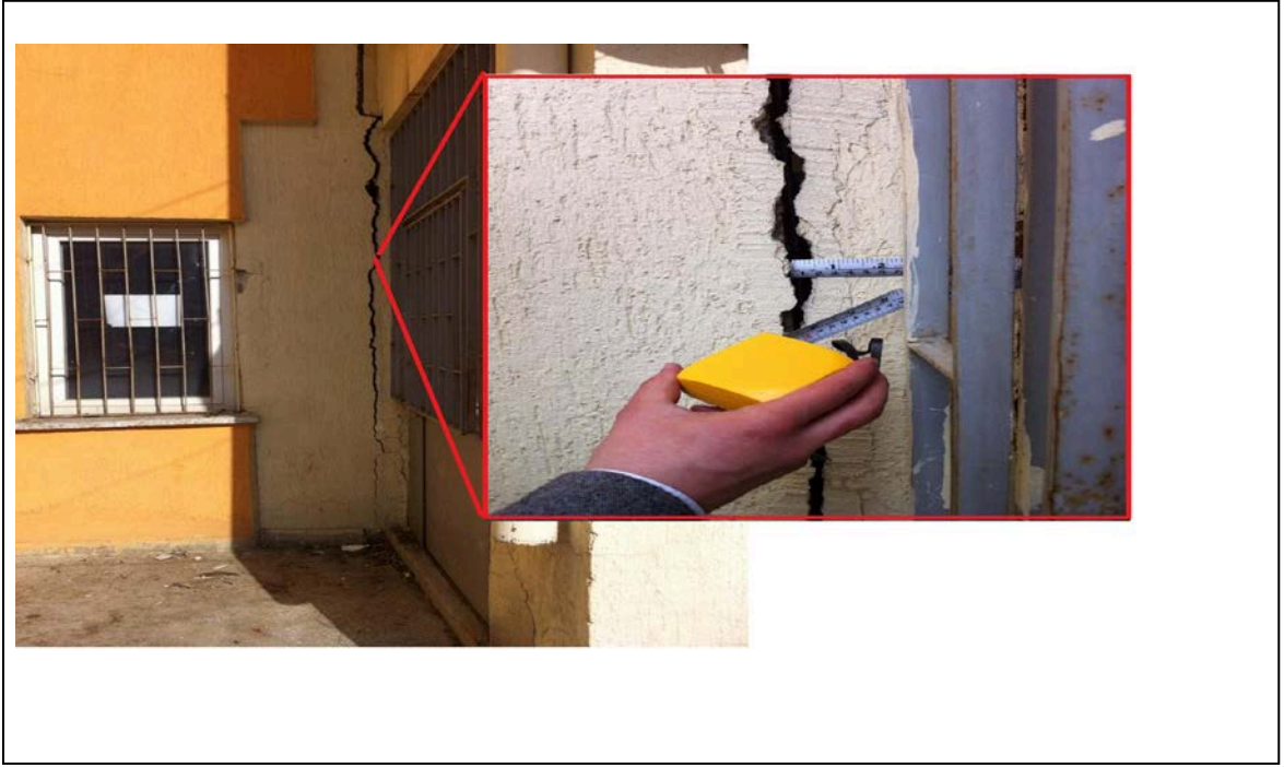
Şekil 5.5. İmam Hatip Lisesi duvarlarındaki hasarlar
