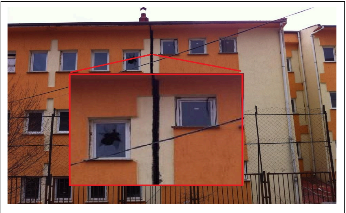
Şekil 5.6. İmam Hatip Lisesi duvarlarındaki hasarlar
