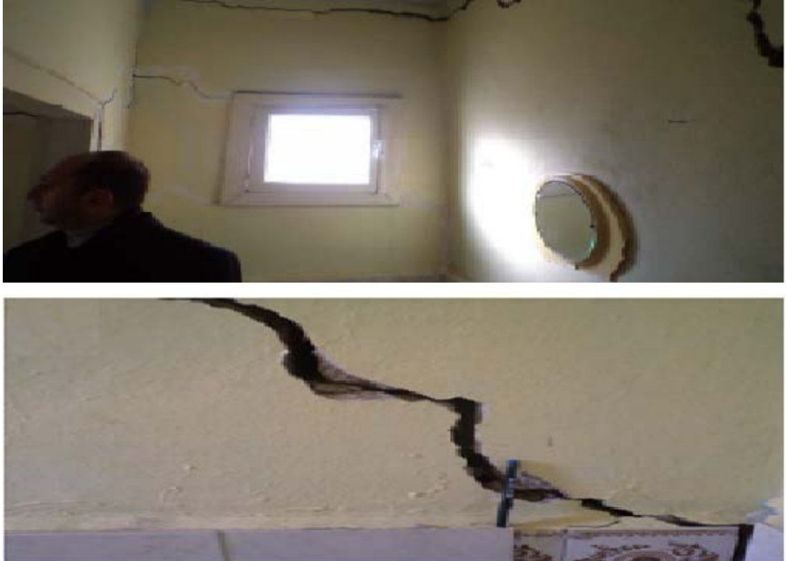
Şekil 5.4. Necip Bülent DOĞRU' ya ait binada zemin hareketliliğine bağlı gelişen çatlaklar (Karslı; Alemdağ; Dağ, 2011).
