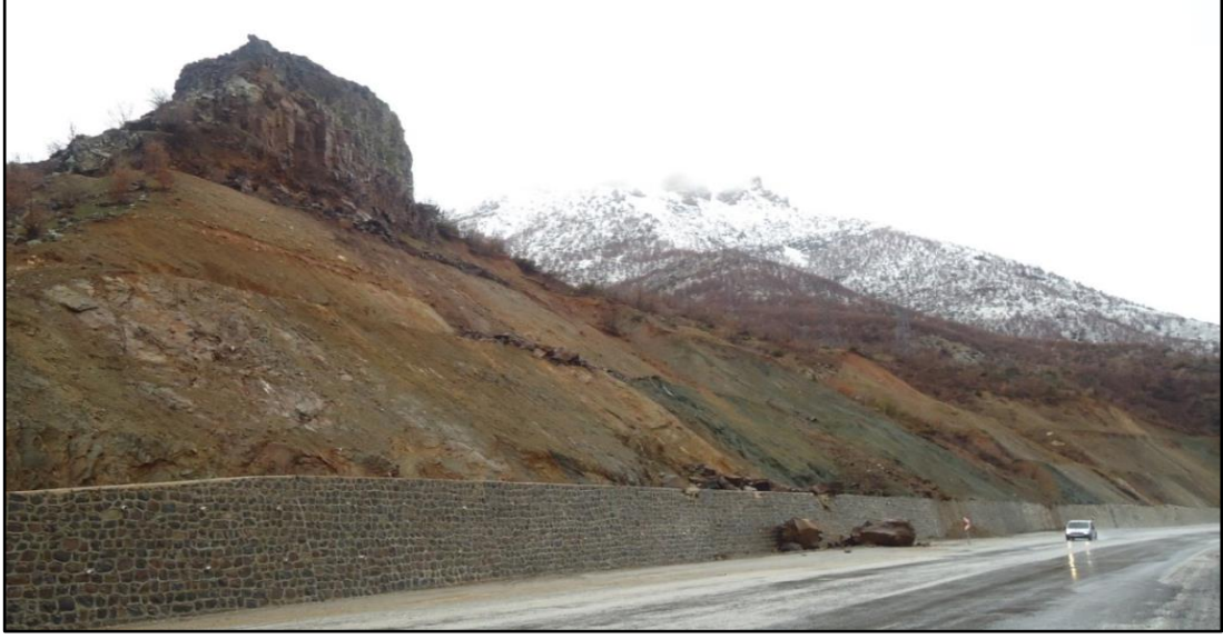
Şekil 1.16. Bitlis-Baykan-9.Bölge hududu devlet yolundaki kaya düşmesi
