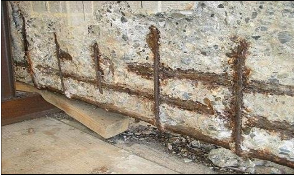
Şekil 1.4. Taşıyıcı bir eleman üzerinde korozyona uğramış donatılara bir örnek
