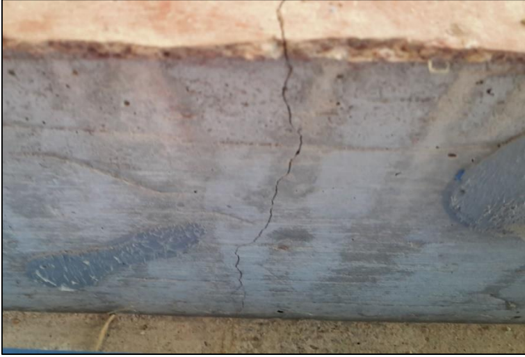
Şekil 1.3. Betonda oluşan çatlaklara bir örnek
