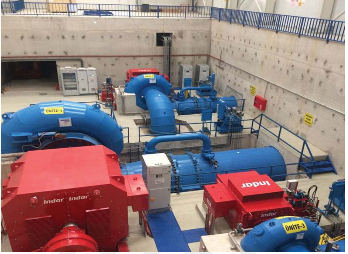
Şekil 3.4. Yumrutepe HES 3 adet senkron jeneratör
