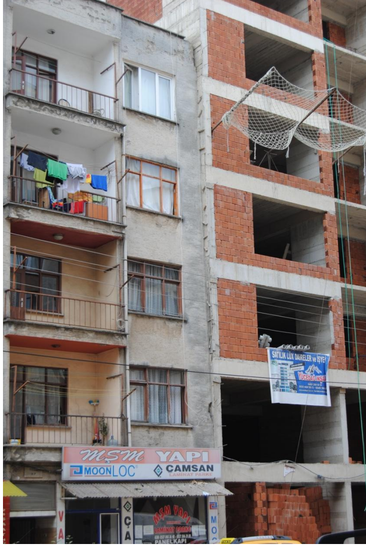
Fotoğraf 8: Hacı Siyam Mahallesindeki Zeminden Kaynaklı Temelde Bitişik Üstte Ayrı Binalardan Bir Görünüm.
