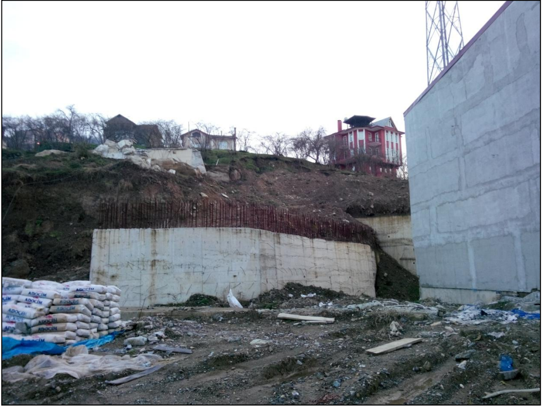
Fotoğraf 3: Çıtlakkale Mahallesiinde İnşaat Yapımı Sırasında Yaşanan Heyelan Olayı (20 Ocak 2015).
