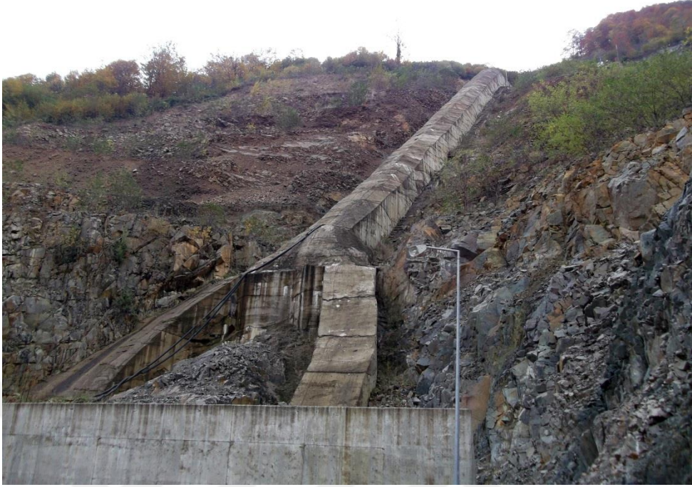
Fotoğraf 15. Ören HES Cebri Borularından Bir Görünüm
