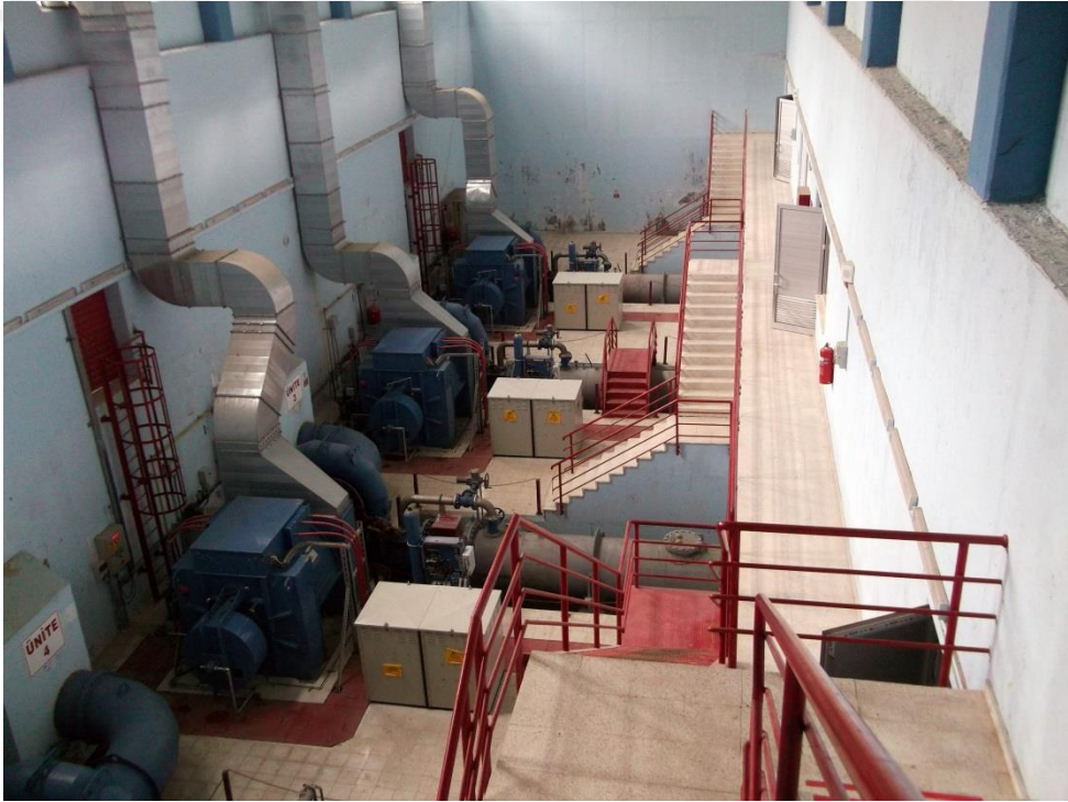
Fotoğraf 16. Ören HES Binası İçerisinde Yer Alan 4 Adet Türbin
