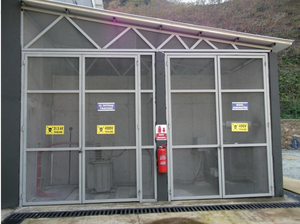
Fotoğraf 11. Zekere HES Trafo ve Dizel Jeneratör
