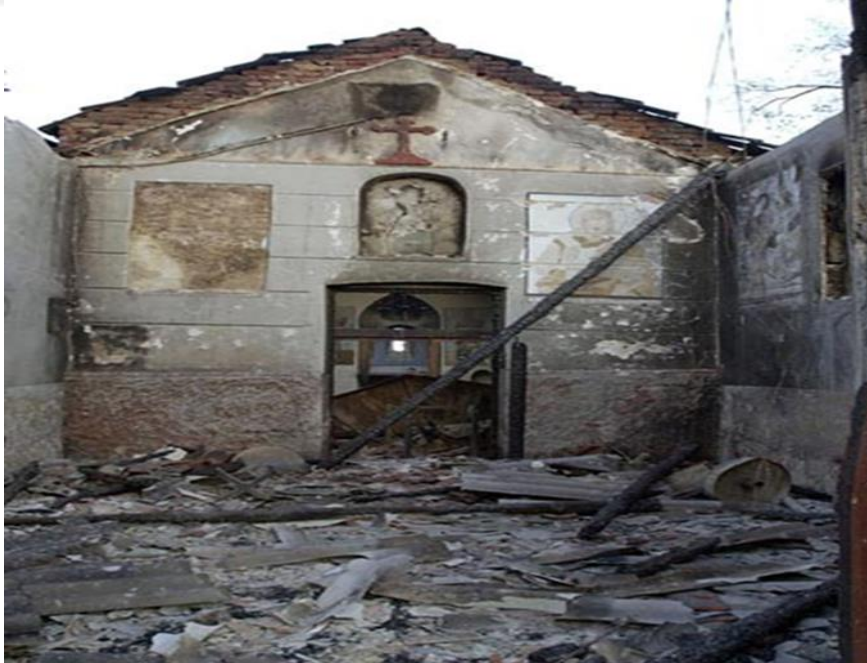
Şekil 4: Mala Recica'da UÇK'nın tahribat ettiği St. George Kilisesi
