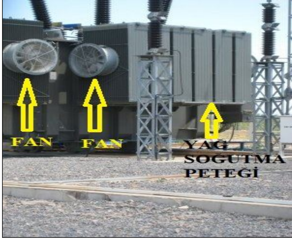
Şekil 2.16: Suni soğutmalı yağlı tip transformatör
