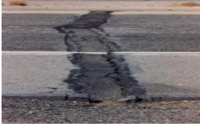
Şekil 2.1: Don etkisi nedeniyle zarar görmüş olan bir yol kaplaması (Günay, 2008)
