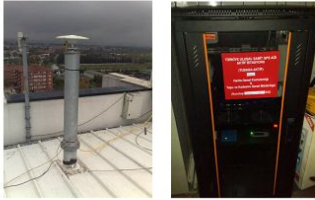
Şekil 8.17: CORS TR Kontrol Merkezi
