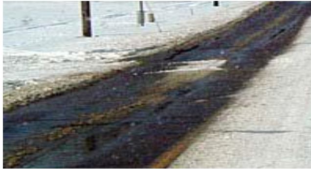
Şekil 2.4: Tuzun zararlı etkilerine maruz kalmış yoldan bir görünüm (Varış, 2007).
