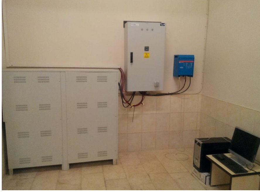
Şekil 3.23. Akü dolabı, elektrik panosu, inverter ve sistemi izlemek için bilgisayarın genel görünümü
