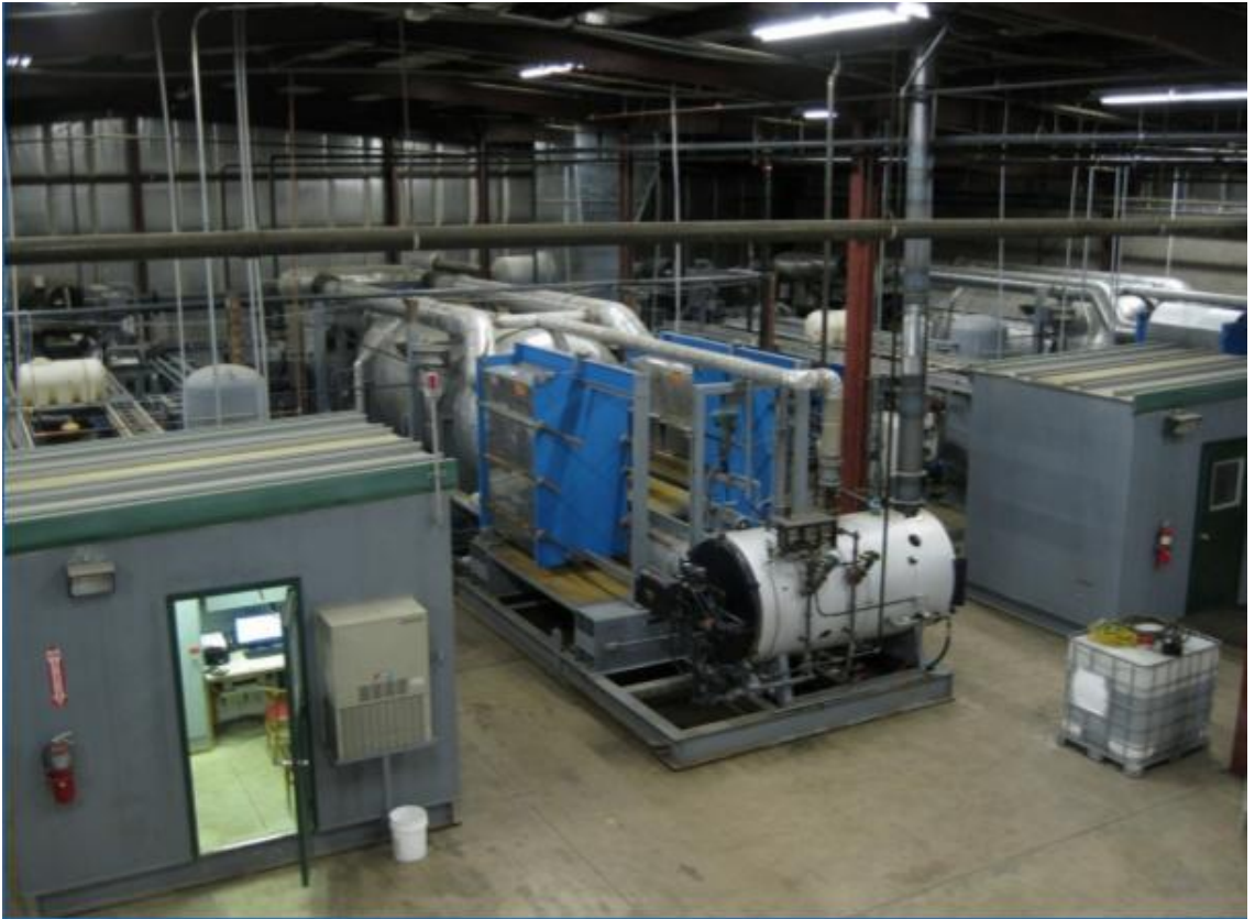
Şekil 2.18. Günde 7500 varil ön arıtma kapasiteli şantiye arıtma tesisi [33]
