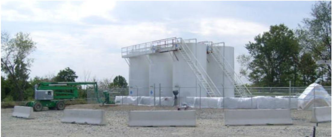
Şekil 2.8. Utica Kaya Gazı depolama tankları [11]
