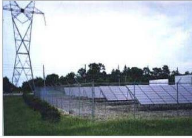
Şekil 2. 6. Şebeke bağlantılı 4,8 kW güneş pili sistemi.
