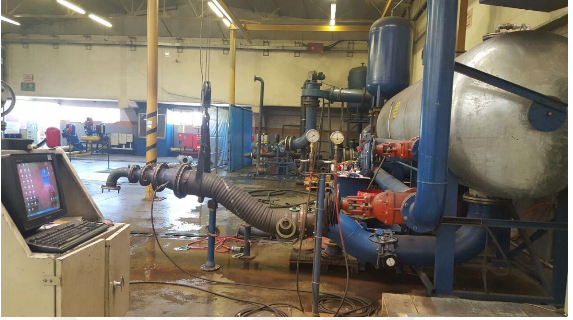
Ek- 7. Pompa test ünitesi.
