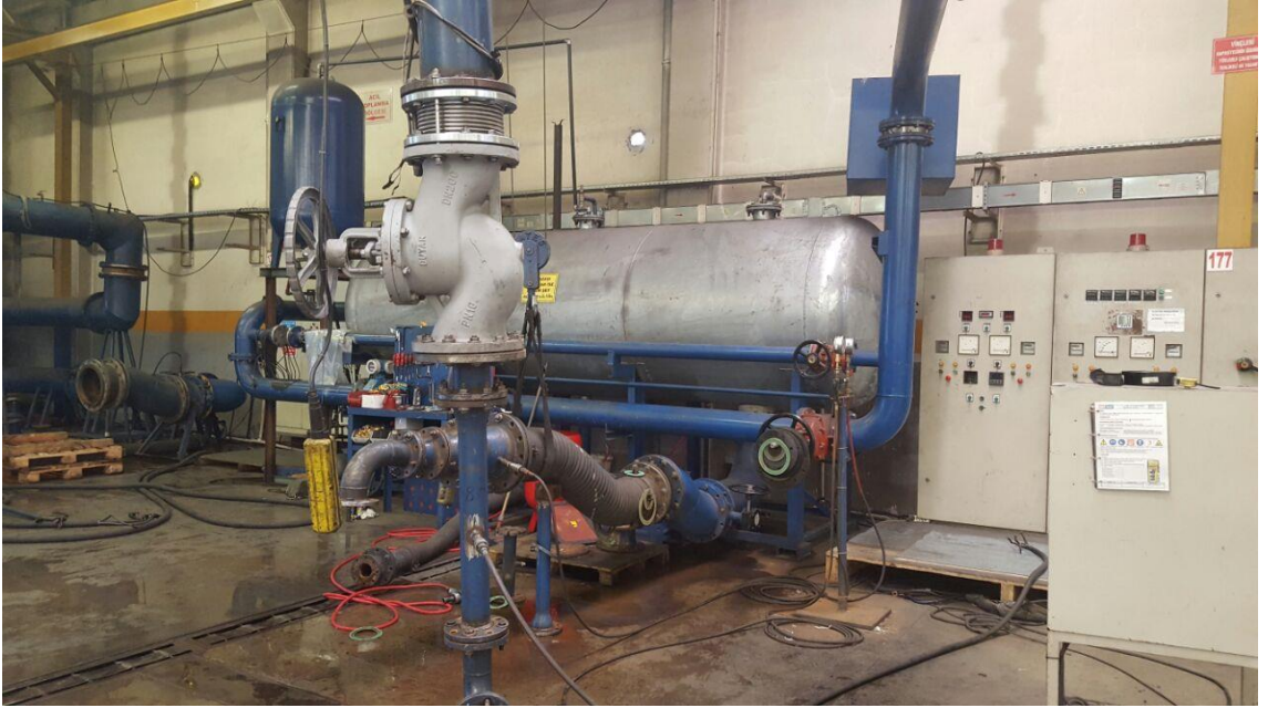
Ek- 8. Pompa test ünitesi.
