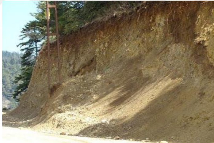
Şekil 4.2. Abant Gölü çevresinde yol genişletme sonucu ortaya çıkan doğa tahribatı
