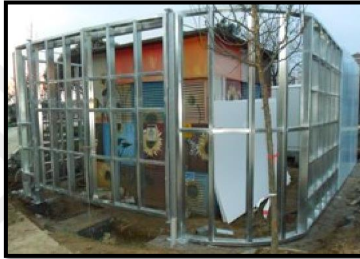
Şekil 1.35. Göztepe 60. Yıl Parkı, Prof. Dr. Hulusi Behçet Caddesi'ne bakan dış mekan dikey bahçenin galvaniz sistem yapımı (Beyhan 2014).
