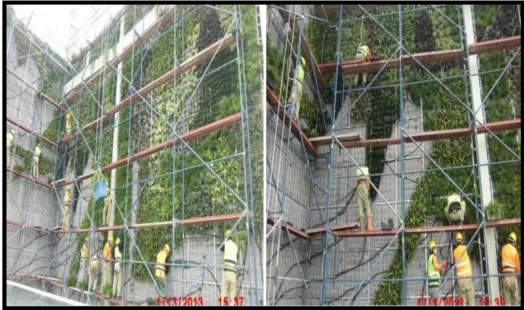
Şekil 3.3. Brandium Alışveriş Merkezi iç mekan dikey bahçe uygulama (Kavi 2016).
