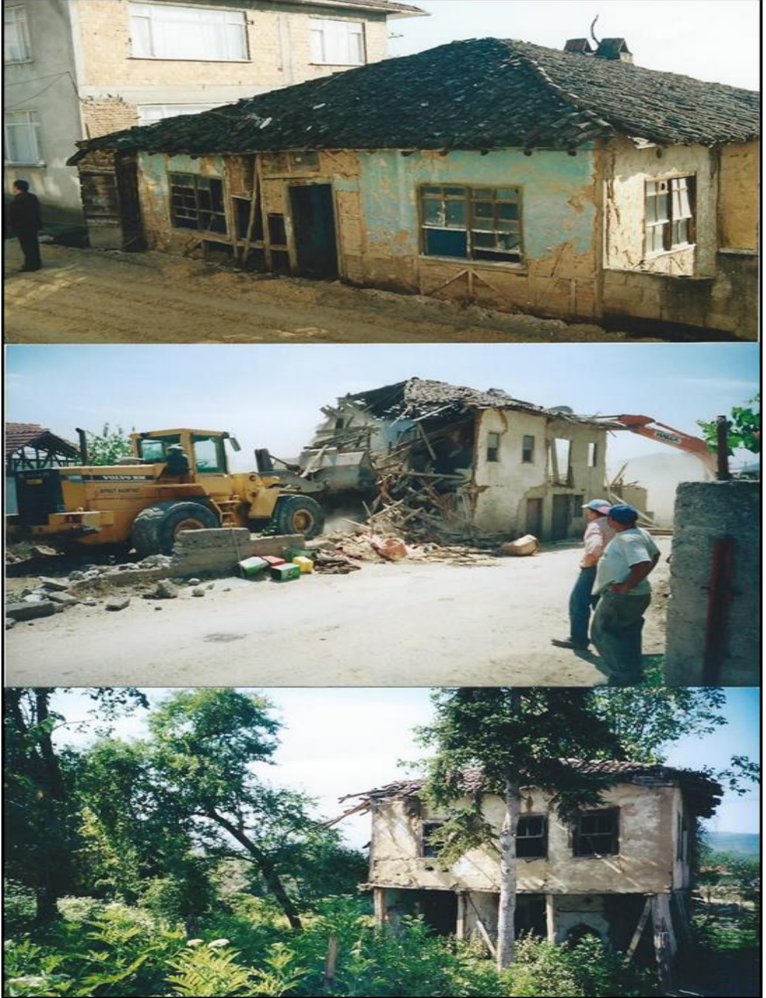
Resim 3.53. Çiftepınarlar mahallesi hasarlı yapılar 1995 (Anonim 2014d.)
