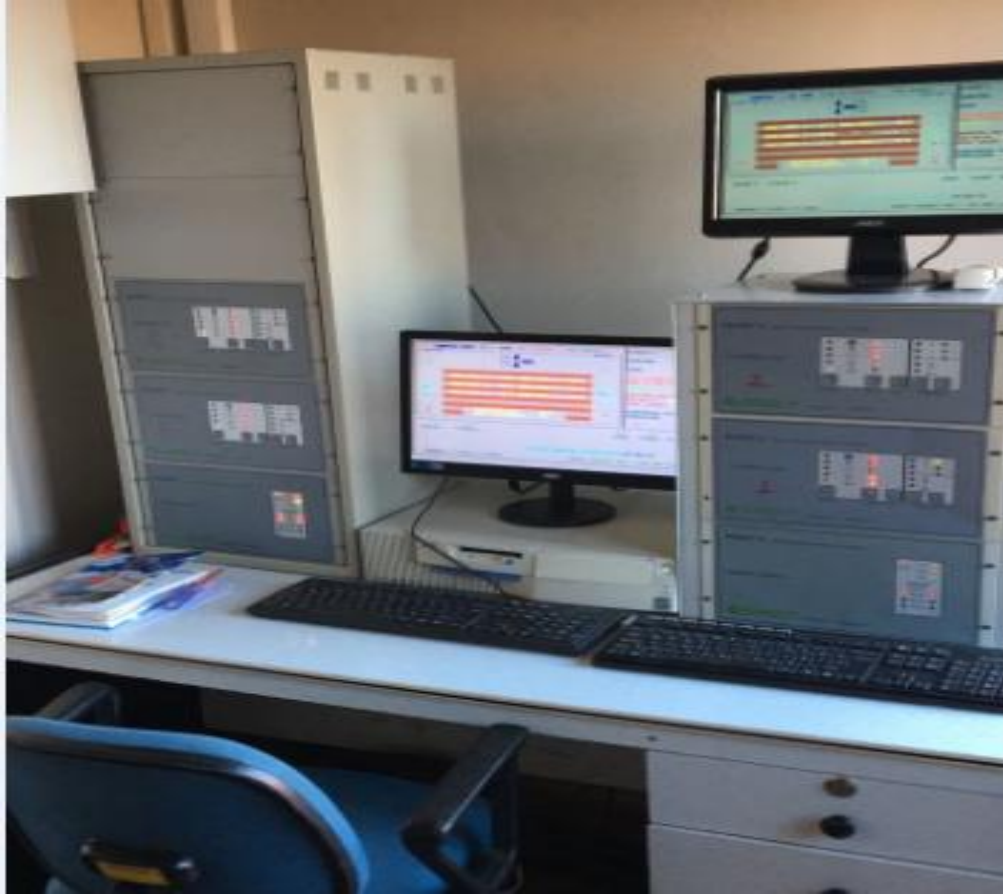
Şekil 2.5. Uygulamanın yapıldığı kurutma fırınına ait kontrol sistemi.
