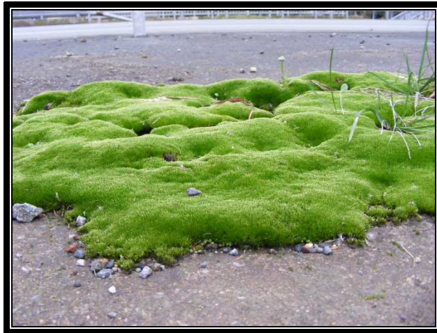
Şekil 1.9 Beton üzerinde gelişen karayosunu (Foto: G. Abay)
