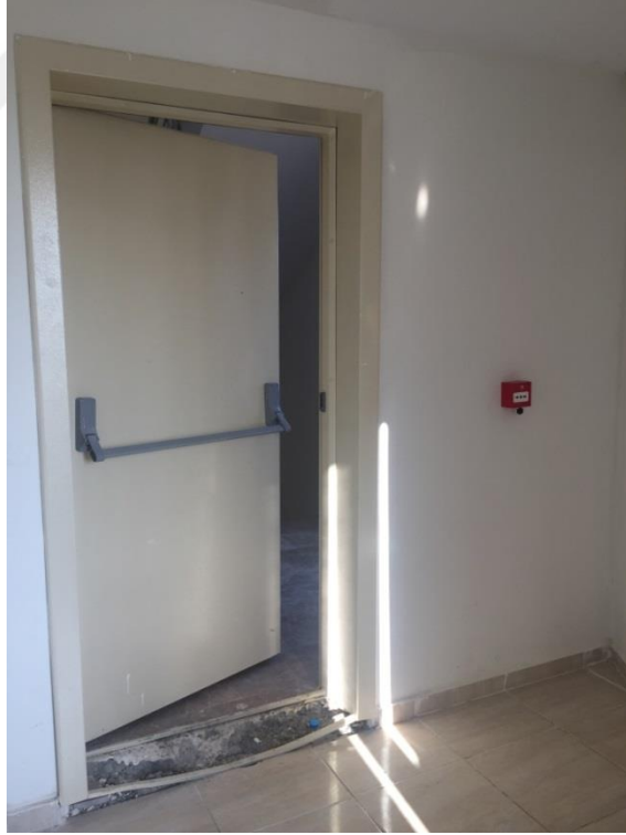
Şekil 34 Kaçış yolu kapılarında meydana gelen kot farklılıkları
