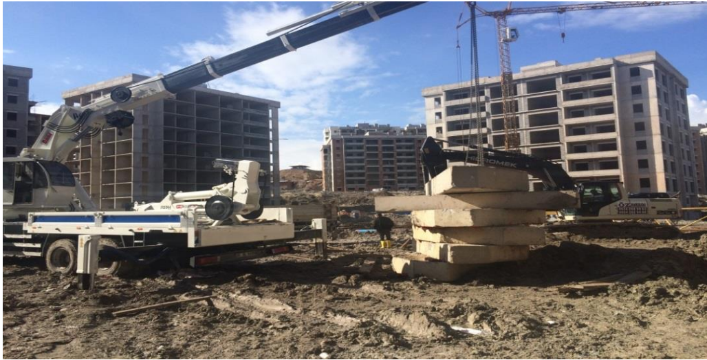
Şekil 26 Hatalı Malzeme Yerleştirilmesi
