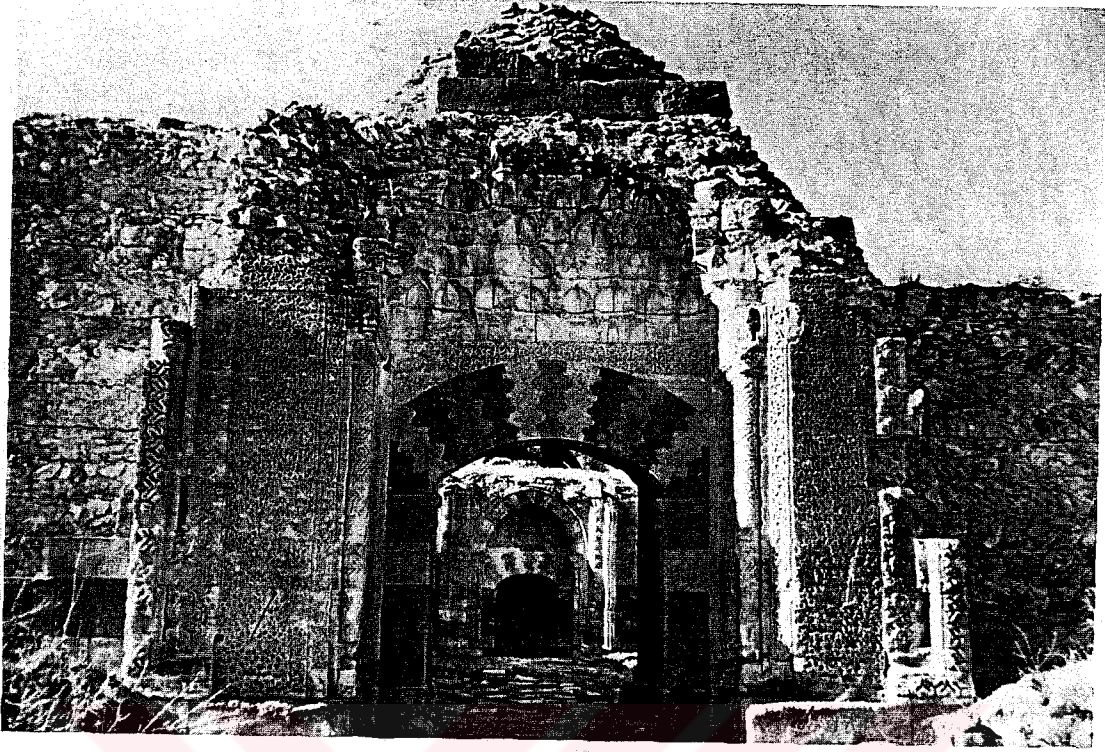
Şekil.2.252. Sarı Han, Onarımdan önce, Taç Kapının Üzerinde Mescit ve Üst Örtüsü (Oktay Aslanapa arşivi)
