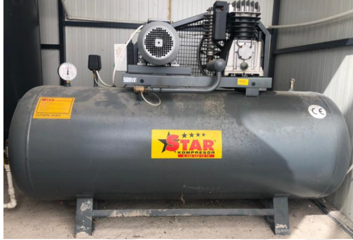
Şekil 2.3. Hava kompresörü ve tankı
