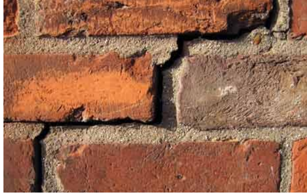
řekil 5-3 Kire Harlı Duvar Hasarı
