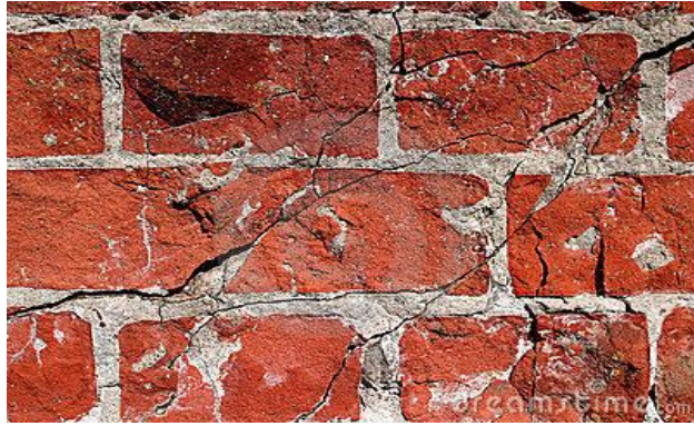
řekil 5-4 imento Harlı Duvar Hasarı
