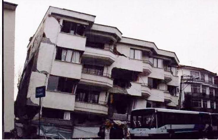
Şekil4.6512 Kasım 1999 Düzce Depremi hasarı (AFAD,2019)
