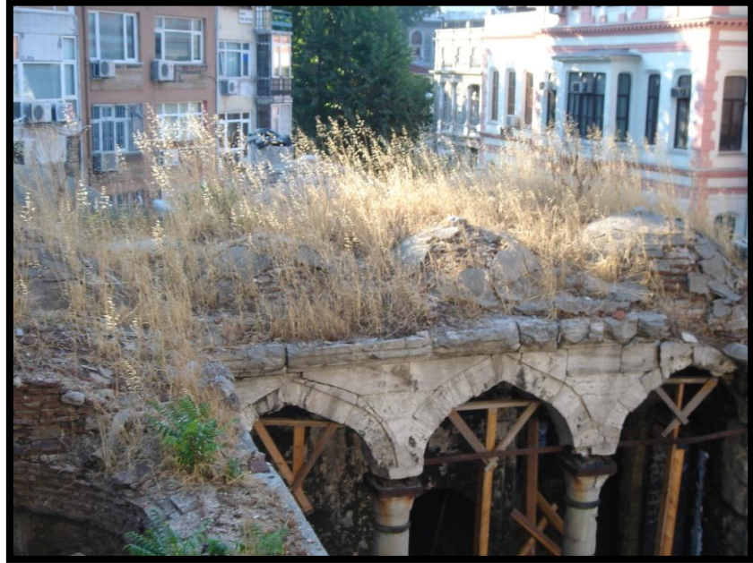
Foto.47. Hadım Hasan Paşa Medresesi-1. Kat Bozulmalar (2007) (Kaynak: Tures Turizm Planlama ve Restorasyon San. Tic. Ltd. Şti.)
