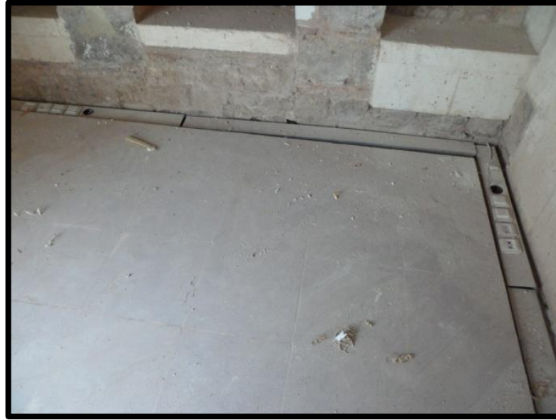
Foto.67. Hadım Hasan Paşa Medresesi-Elektrik Çözümü (2011)
