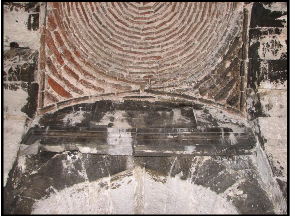
Foto.45. Hadım Hasan Paşa Medresesi-1. Kat Bozulmalar (2007)
