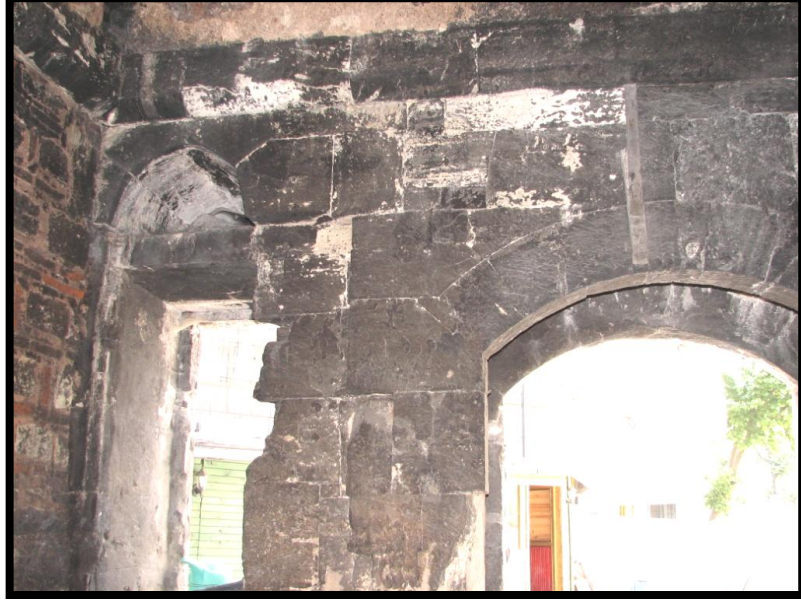
Foto.41. Hadım Hasan Paşa Medresesi-Zemin Kat Bozulmalar (2007) (Kaynak: Tures Turizm Planlama ve Restorasyon San. Tic. Ltd. Şti.)
