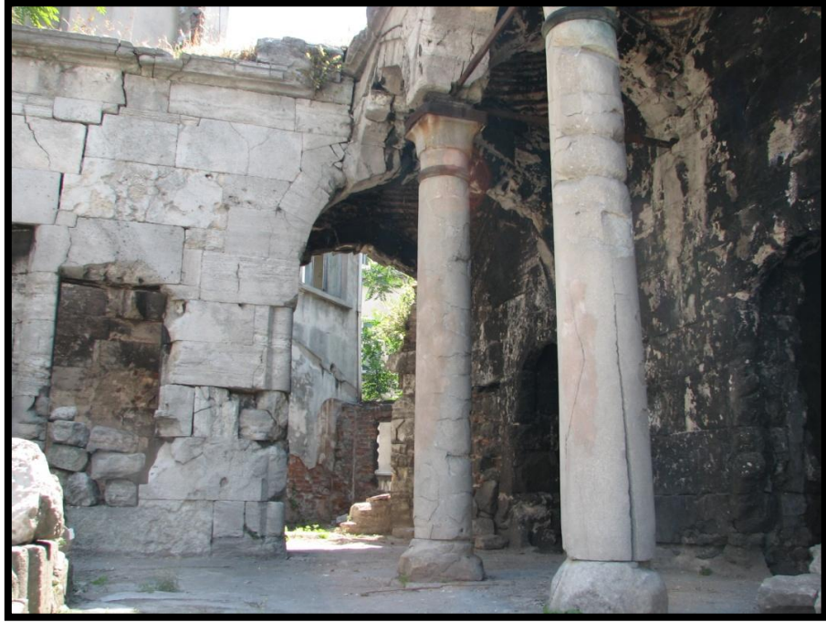
Foto.43. Hadım Hasan Paşa Medresesi-1. Kat Bozulmalar (2007)
