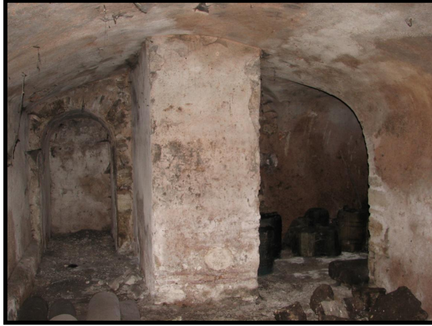
Foto.40. Hadım Hasan Paşa Medresesi-Bodrum Kat Bozulmalar (2007)
