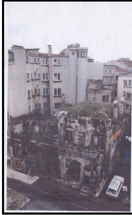
Foto.16. Hadım Hasan Paşa Medresesi-1865 Yangınından Sonraki Hasar Görmüş Hali
