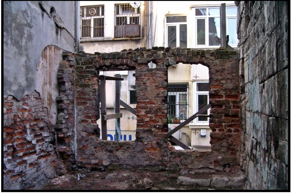
Foto.44. Hadım Hasan Paşa Medresesi-1. Kat Örtü Sistemi Bozulmalar (2007)
