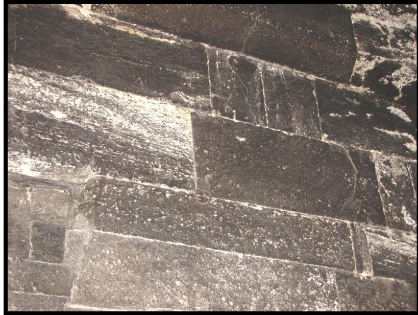
Foto.42. Hadım Hasan Paşa Medresesi-Zemin Kat Bozulmalar (2007) (Kaynak: Tures Turizm Planlama ve Restorasyon San. Tic. Ltd. Şti.)
