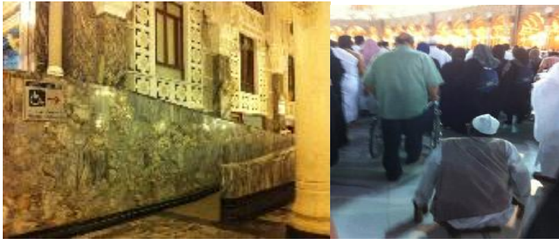
Resim 4.15: Mescidi Haram'a Girişte Engelli Rampası ve Erişilebilirliğe Uygun Zemin Kaplaması kaynak: Çenet Arşivi, 2013 E.T: 15.03.2013
