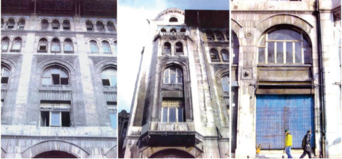
Resim.5.20. Restorasyon öncesi hanın fiziksel olarak aşınmış cephe görünümüleri
