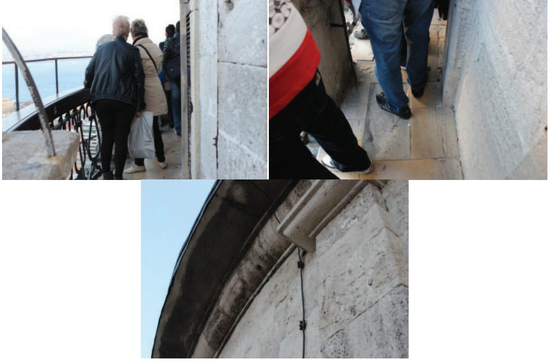
Resim.5.316. Galata Kulesi seyir terası görünümü ve sivri külahın zamanla aşınmış olan saçağının görünümü
