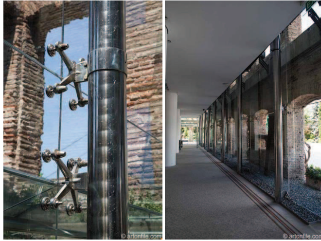
Resim.5.275. Restorasyon sonrası, 'The Marmara Esmâ Sultan'ın cam ve çelikten oluşan iç mekan ve detay görünümleri
