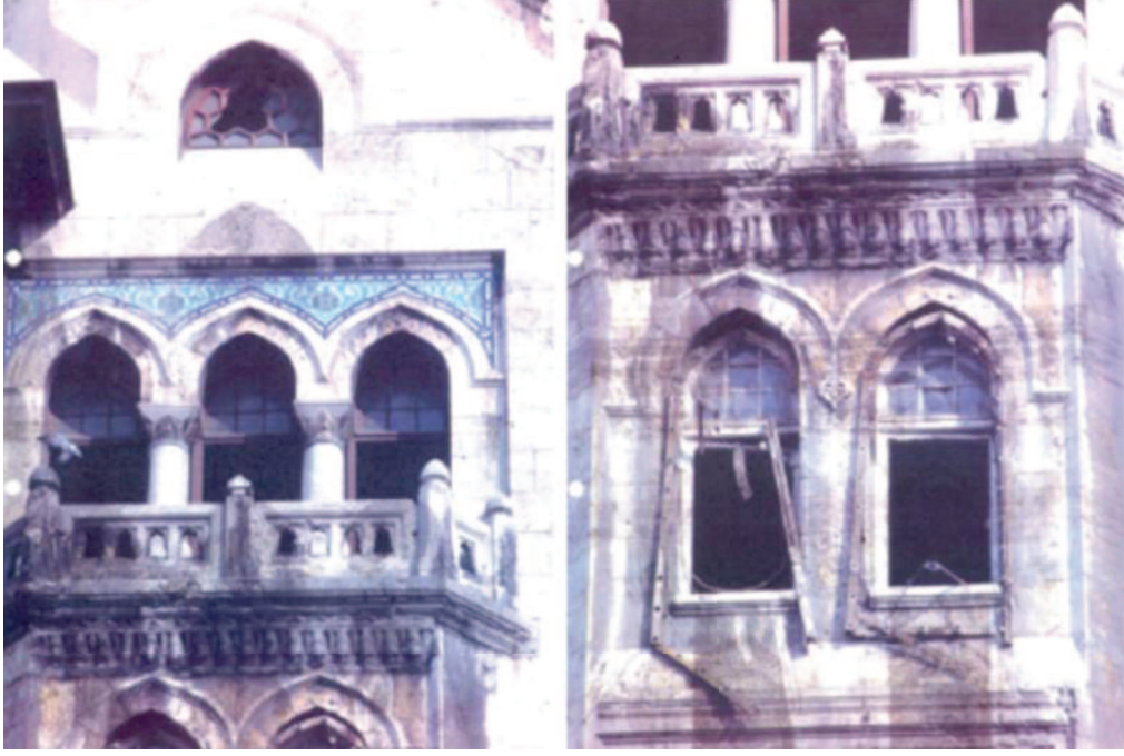
Resim.5.19. Restorasyon öncesi hanın fiziksel olarak aşınmış cephe görünümüleri
