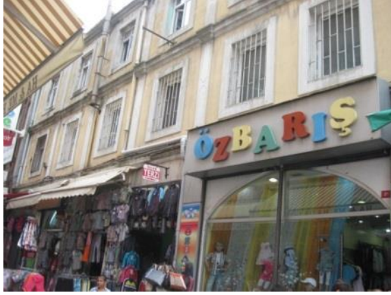
Fotoğraf.40. Cephe Bozulması Cebeci Han (Hakyemez Arşivi, 2013)
