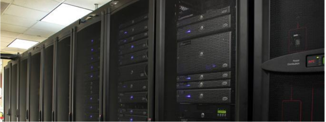
Şekil.7. Veri merkezinde barındırılan sunucular.
